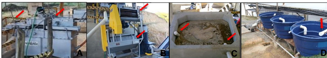
Figura 4 - Vista parcial dos pontos de distribuição de água na unidade de processamento dos frutos do cafeeiro. Fazenda Experimental de Venda Nova do Imigrante-ES, 2013: (A) Lavador/separador; (B) descascador e separador de casca; (C) Tanque de degomagem (entrada e dreno de escoamento); e (D) Sistema de limpeza de água residuária durante o início do processamento.
