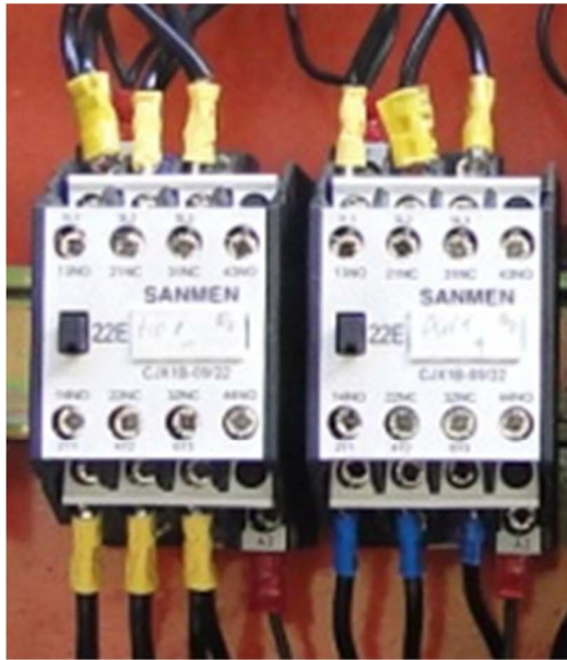
FIGURA 2.03 Detalhe dos contatores para manobra dos motores da direção.
