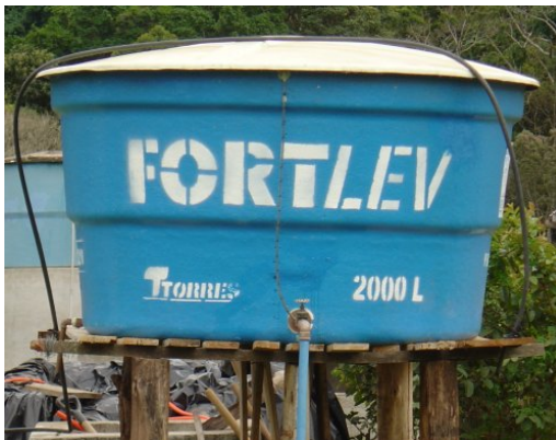
Figura 4.3. Tanque de equalização
