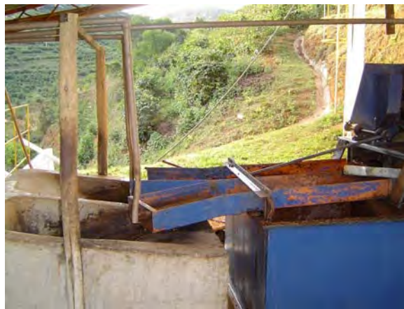
Figura 3 – Detalhe do lavador mecânico
