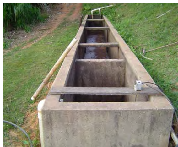
Figura 5 – Vista frontal do tanque de decantação
