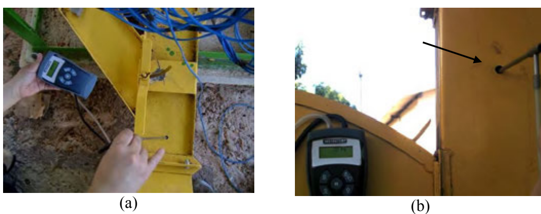
Figura 3.32 - Detalhes dos pontos de medição da velocidade do ar aquecido: (a) após ventilador; (b) duto vertical após a bifurcação para descarga do secador.
