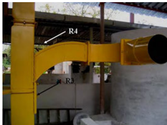
Figura 3.13 - Detalhe da ligação do duto de transporte principal com o duto de descarga do secador.
