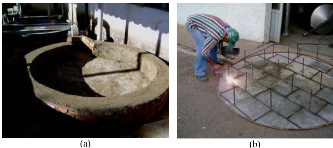
Figura 3.18 - Detalhes da base do silo secador-armazenador: (a) base-câmara plênum ; (b) piso em chapa perfurada e fixação das hastes de sustentação do piso.
