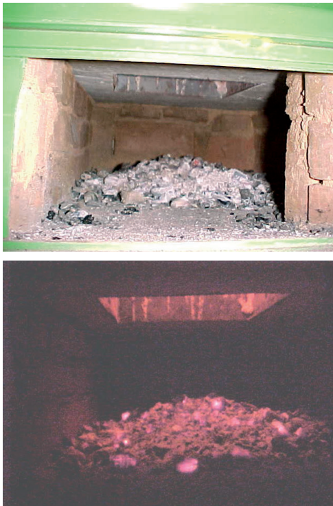
Figura 13. Compartimento cinzeiro onde é mostrada abertura na laje da câmara de combustão por onde caem as cinzas.
