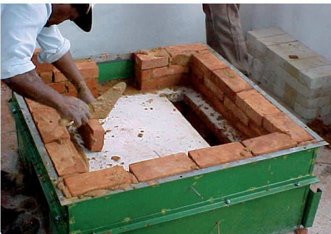
Figura 3. Revestimento interno dos módulos que compõem a fornalha.
