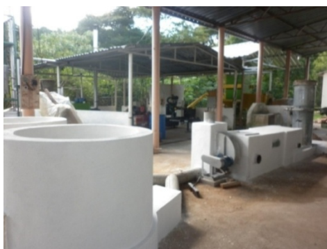
Fig. 3. Sistema gaseificador-silos construído para secagem de café
