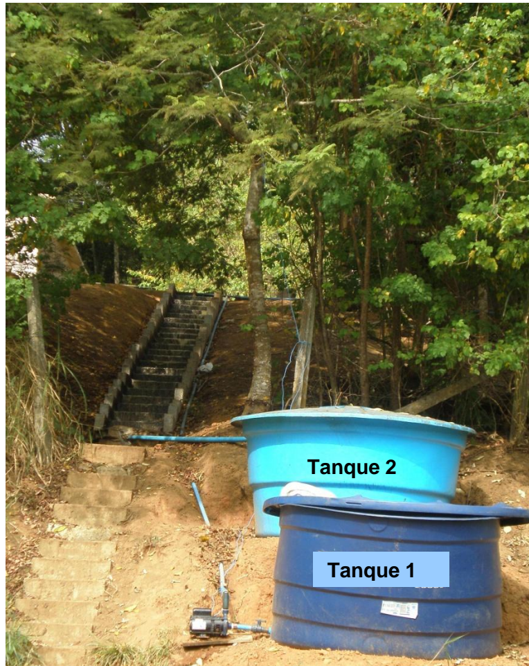
Figura 4. Vista geral do sistema de aeração em cascata.
