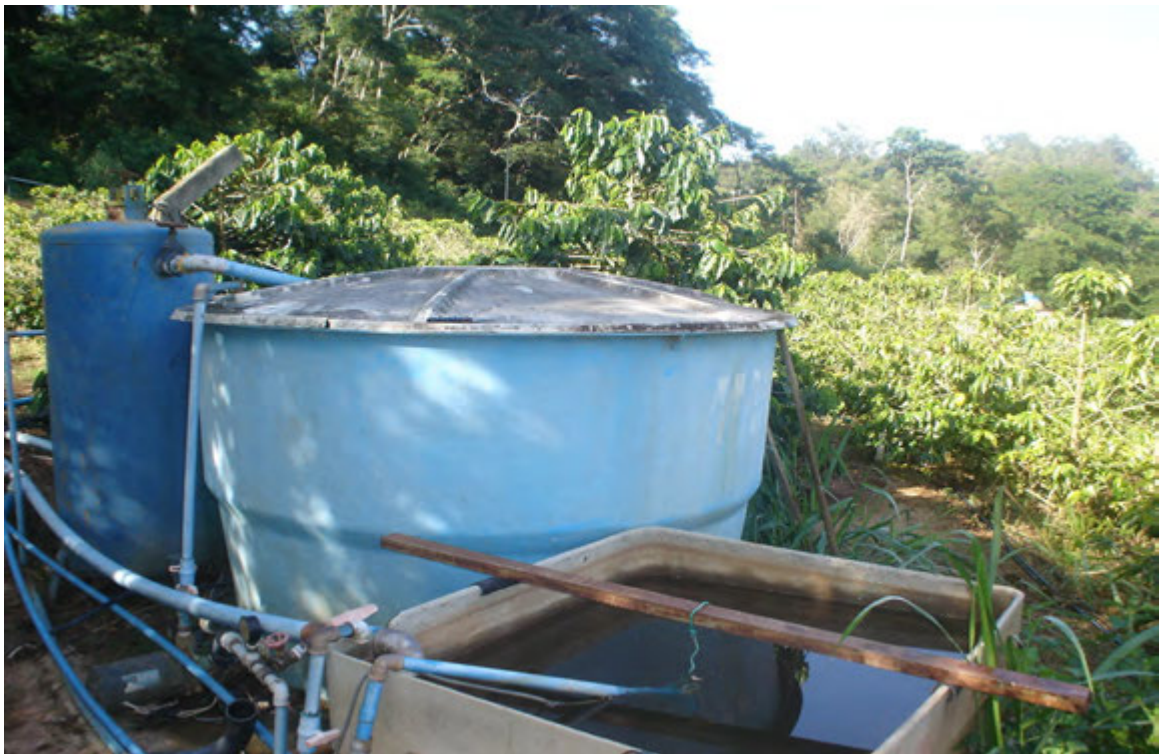
Figura 1. Infra-estrutura utilizada na aplicação de esgoto doméstico. Contendo filtro de areia (esquerda), caixa de armazenamento de esgoto filtrado (centro) e caixa de água (direita).
