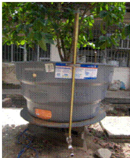
Figura 17 - Observador de nível instalado no lisímetro.
