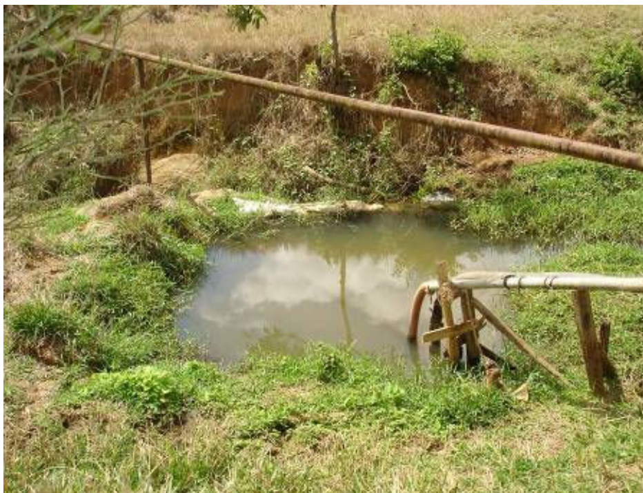
Figura 42 – Captação direta no Córrego Sossego. Detalhe para estrutura de contenção construída dentro do leito do córrego.
