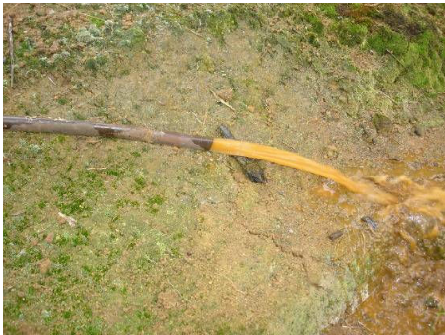
Figura 31 – Falta de abertura do final das linhas laterais provocando o acúmulo de detritos no interior das tubulações, entupimento de emissores e queda na uniformidade de distribuição. Detalhe para água de má qualidade observada.
