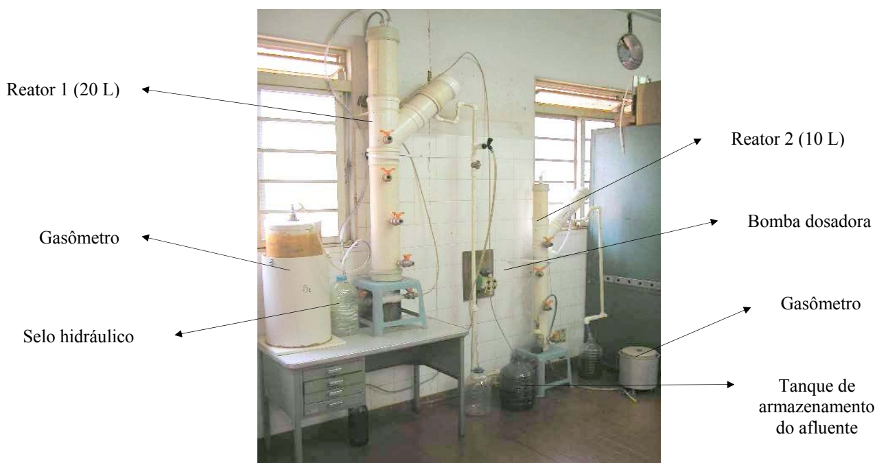
FIGURA 1. Sistema de tratamento anaeróbio composto de reatores UASB em dois estágios, bomba dosadora, tanque de armazenamento de afluente, selos hidráulicos e gasômetros. Anaerobic treatment system composed of UASB reactors in two stages, dosing pump, storing tank of affluent, hydraulic seals and gas meters.
